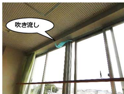
図 3-87 窓を開けた時の風の流れを吹き流しで確認(例)
