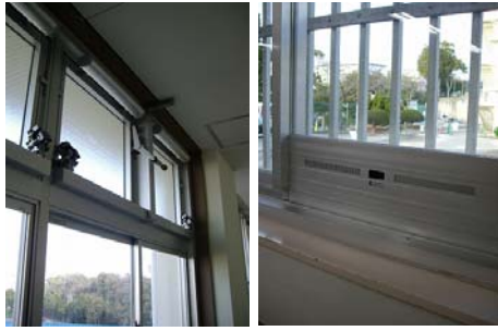
兵庫県神戸市立多聞東中学校 4 スウィンドウ+夜間換気用ガラリ
