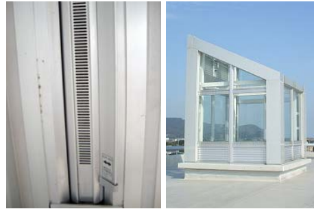
福岡県北九州市曾根東小学校 4 教室の換気ガラリ+ソーラーチムニー
