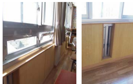
福井県若狭町立三方中学校 4 教室の換気窓 ※1
