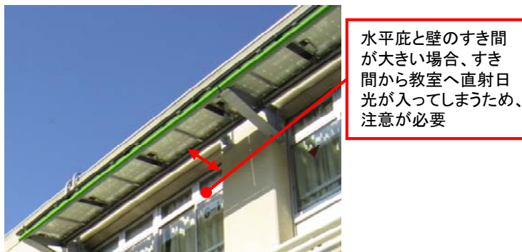
図 4.3.43 水平庇と壁のすき間
