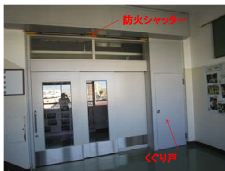
図 4.3.98 防火シャッター(荒川区立第七峡田小学校)
